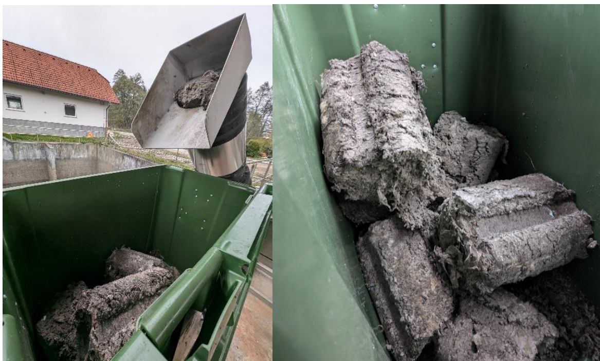
Slika 13: Kompaktor iz odpadkov, katerega prestrežejo grobe grablje na vtoku iztiska vodo. V samem procesu torej znižuje volumen in težo odpadka (iztiska vodo) ter smrad s pomočjo izpiranja. Končni produkt pada v zabojnik.
